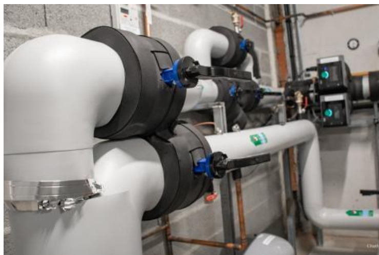
Pompe à chaleur géothermique installé au Collège d'Ecueillé © CD36
